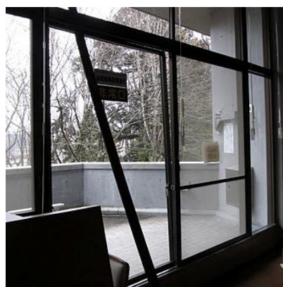
【窓枠の歪み(開閉不能)】
