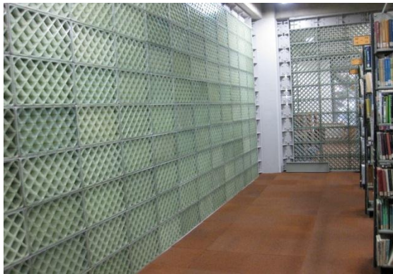
【FRP ブロック耐震壁】 (ガラス繊維強化プラスチック)
