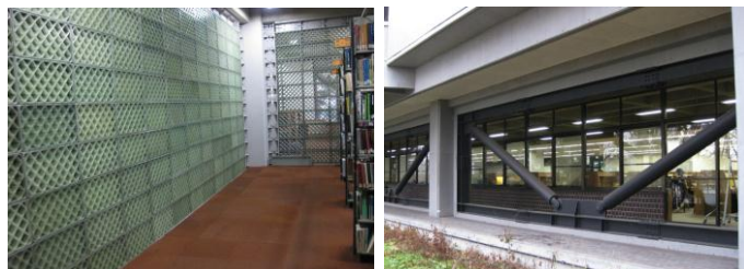
◇ FRPブロック耐震壁 (ガラス繊維強化プラスチック)
