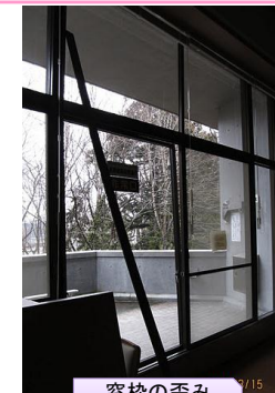
窓枠の歪み (開閉不能)
