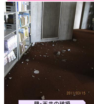
壁・天井の破損 (コンクリート塊の落下)
